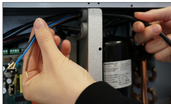
6. Faites passer le conducteur de la sonde de CO 2 par le chemin de câbles vers le système de régulation. Ensuite les conducteurs sont fixés avec des bandes de câbles.
